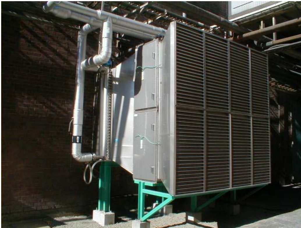
Figur 6-4 Fläktluftekylarna kylvor luften till ca +1 °C. Två luftekylare är här parallellkopplade för att möjliggöra avfrostning under drift.
