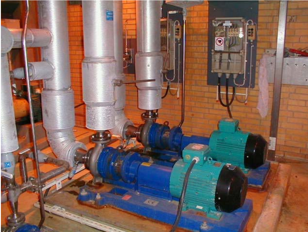
Figur 6-2 De två frekvensstyrda köldbärarpumparna har magnettransmission som minimerar risken för läckage.
