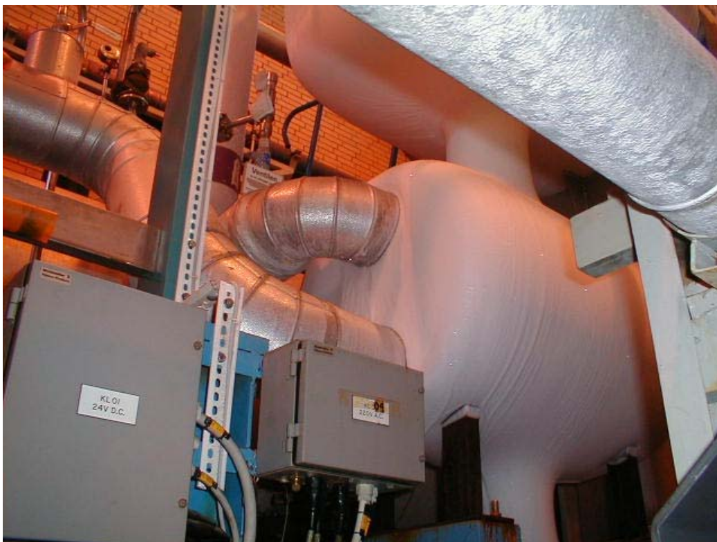
Figur 6-5 Förångarvärmväxlaren befinner sig under flashtanken. Köldbäraren strömmar i de isolerade rören som går in i gaveln. Köldmediet strömmar nedifrån och upp i de oisolerade rören.
